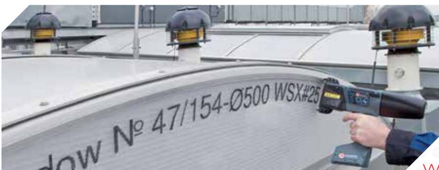
Oznakowanie niedostępnych elementów instalacji budynków, druk po łuku.
